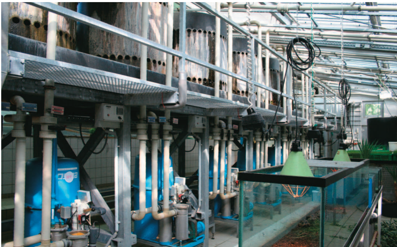
Jedes der Großaquarien hat seinen eigenen Wasserkreislauf mit Filter. So können die Aquarien unterschiedlich stark gekühlt werden und eventuelle Krankheitserreger können sich nicht ausbreiten.
